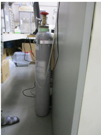
ガスボンベの固定が不十分
