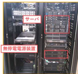
サーバラック (前面)
