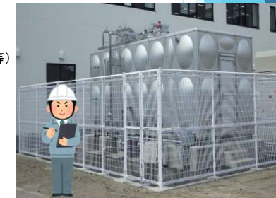
大学施設内の受水槽
