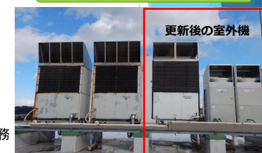
大学施設内の空調設備
